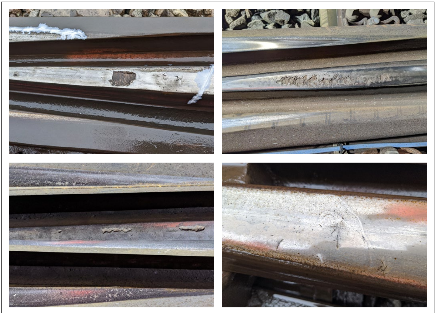
Abb. 4: Weichenschäden, die automatisiert behoben werden können: Abnutzung an Flügelschiene und Weichenherz sowie Ausbruch an Herzstückspitze auf bereits repariertem Abschnitt | Ausbrüche an Herzstückspitze aufgrund zu niedriger Flügelschiene / einseitiger Belastung | Risse und Ausbrüche an Flügelschiene und Herzstückspitze | wasserstoffinduzierter Riss durch fehlerhaftes Vorwärmen (Bildcollage vier Bilder)
